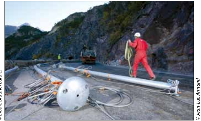
Le chantier de sécurisation de l'accès au Queyras est terminé après plusieurs mois de travaux. Les élus du conseil général ont visité le chantier terminé et inauguré la nouvelle route sécurisée (lire aussi page 5).
