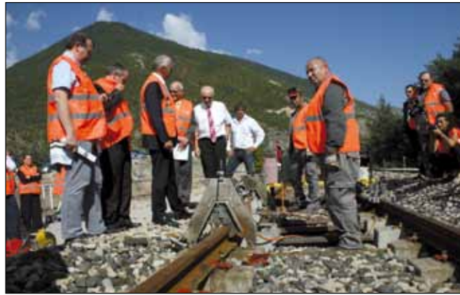
Visite du chantier de rénovation de la ligne des Alpes engagé par Réseau ferré de France, auquel le conseil général participe à hauteur de 5 millions d'euros.
