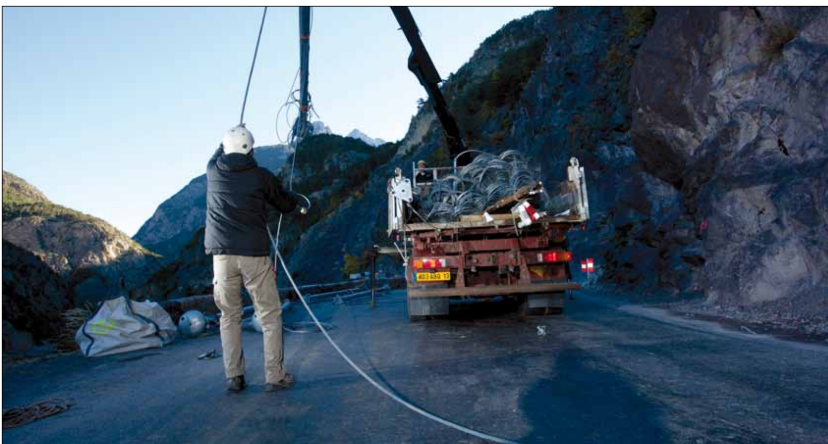
Le chantier des Roches Violettes, dans le Queyras, est un exemple type de sécurisation d'itinéraire contre les chutes de blocs.
