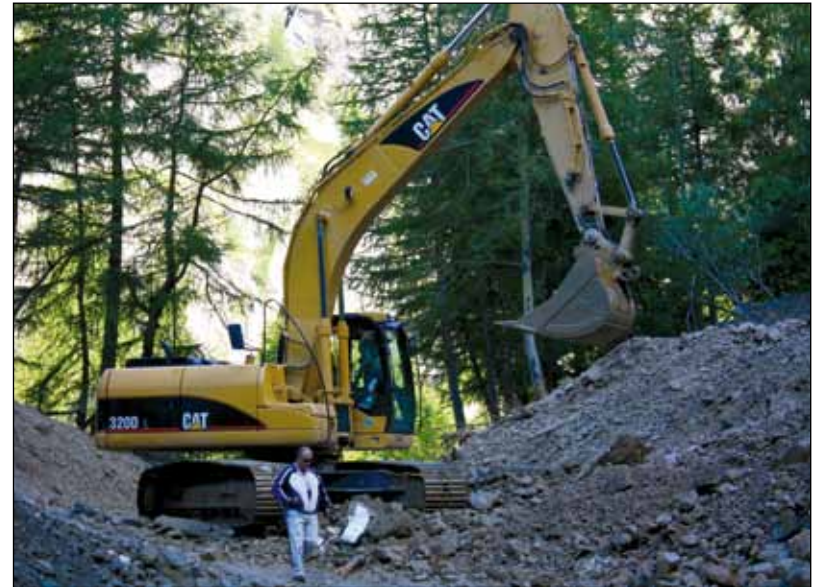
Les glissements de terrain, comme ici sur la route du Pré de Madame Carle, sont impressionnants et peuvent bloquer des usagers.
